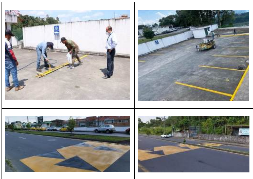
Imagen 2. Señalética en el parqueadero de la Dirección Provincial y rompe velocidad CCQA
