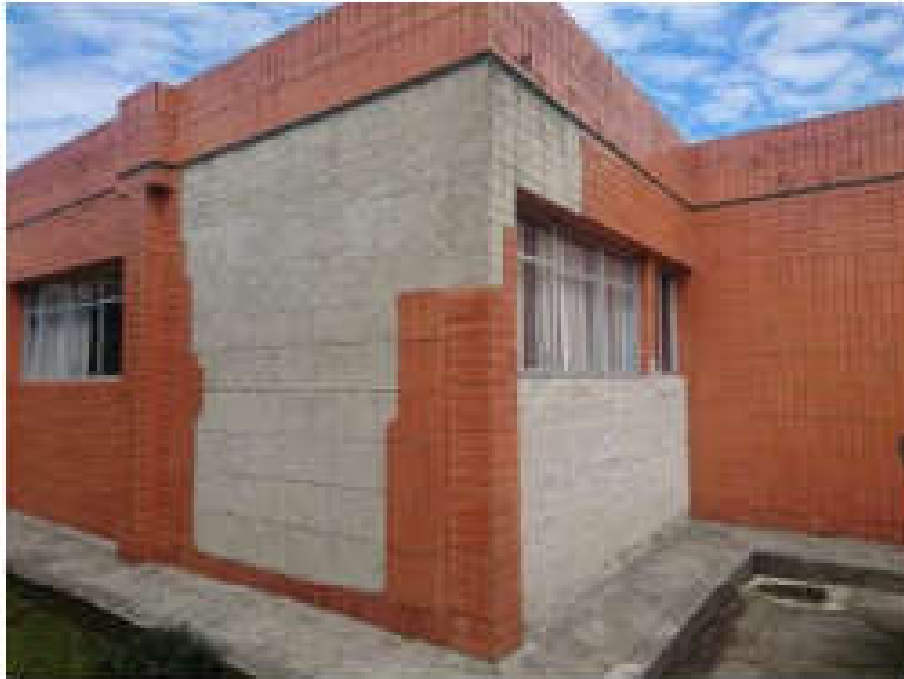
Fotografía 2. Necesidad de mantenimiento Hospital del Día Macas
